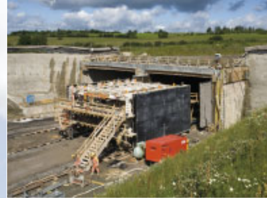
Bereit zum Einfahren in den Tunnel. Mit dem Betonieren wurde am bergmännischen Ende des Tunnels begonnen.
