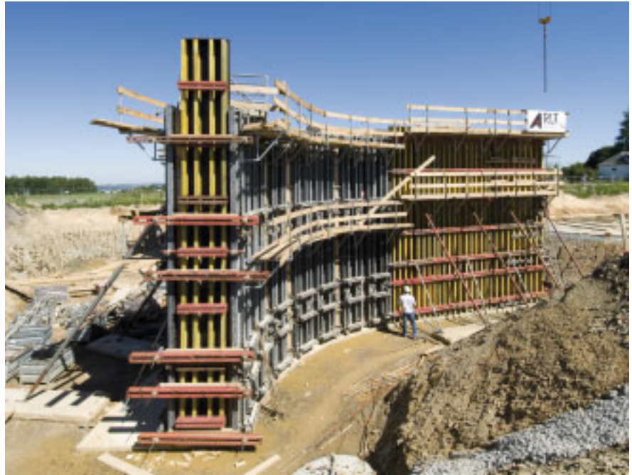
Weil sich die Fahrbahn auf einer Seite der Brücke aufweitet, sind zwei unterschiedliche Widerlager notwendig.
