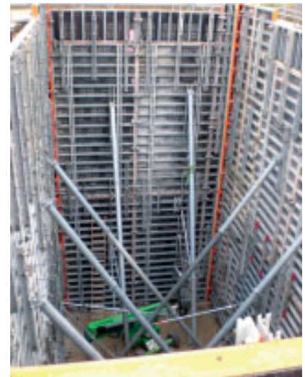
Zum Einsatz kamen u. a. NOEtop XXL Schaltafeln. Diese sind mit 5,30 x 2,65 m und über 14 m 2 Schalfläche die größten auf dem Markt erhältlichen Schaltafeln.
