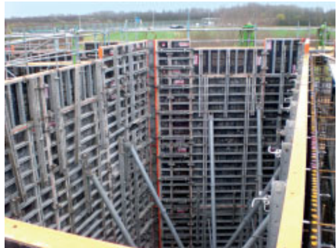
Impressionnant : seuls trois panneaux de coffrage NOE-top ont été nécessaires pour une superficie de coffrage de plus de 30 m 2 .
